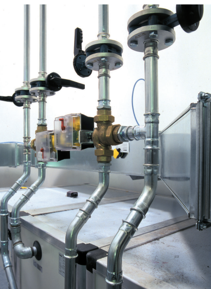
Fig. 15 - Instalación de calefacción industrial.
