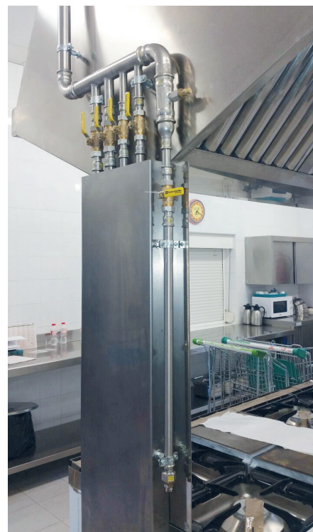
Fig. 24 - Instalación gas en cocina.
