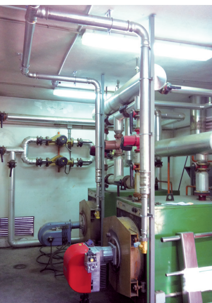
Fig. 22 - Instalación gas para quemadores en caldera industrial.
