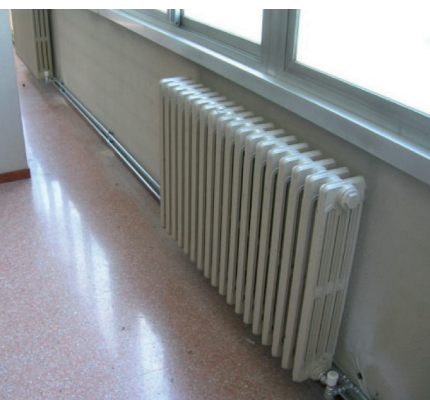
Fig. 16 - Instalación de calefacción por radiador.
