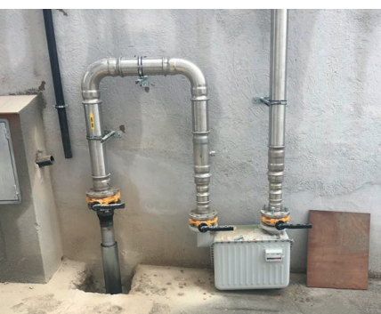
Fig. 23 - Instalación gas en industria.
